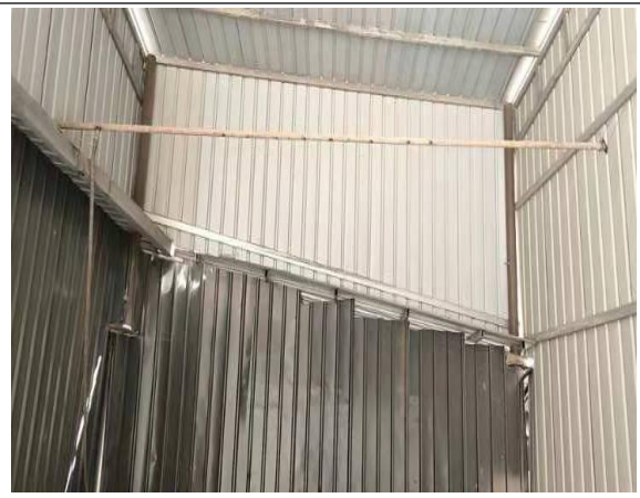
进料口喷淋装置
