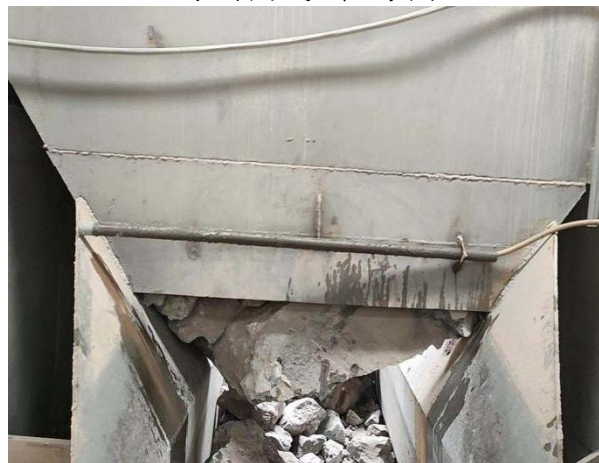
破碎设备喷淋装置
