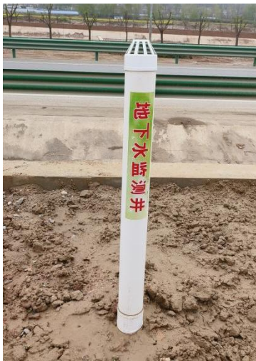
地下水监控井
