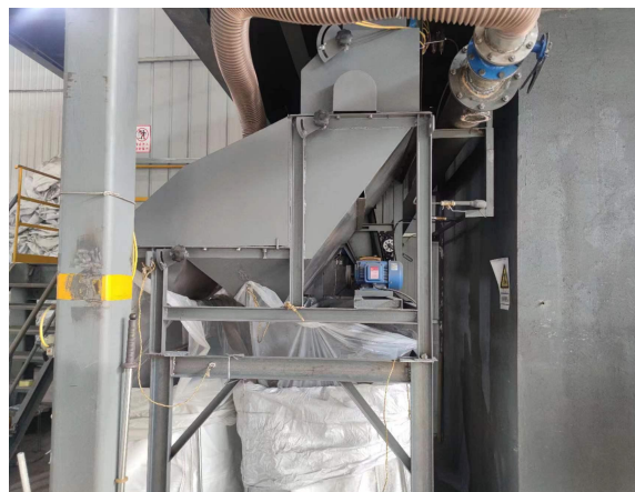
除铁粉下料口
